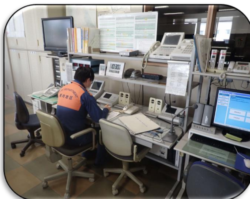
猿払支署 通信指令台
