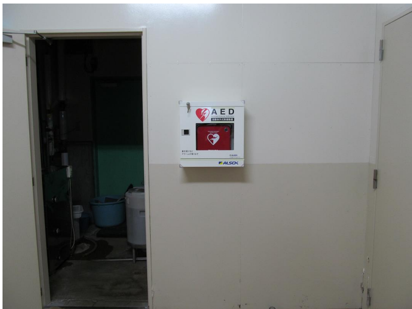
ボイラー室前の通路にAEDがあります。
